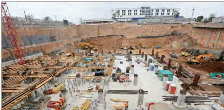
NUEVO COMPLEJO. — Las obras en el hospital "Claudio Vicuña", de la comuna de San Antonio, comenzaron este año. Más del 12% del financiamiento del recinto ya está comprometido vía fondos espejo.
